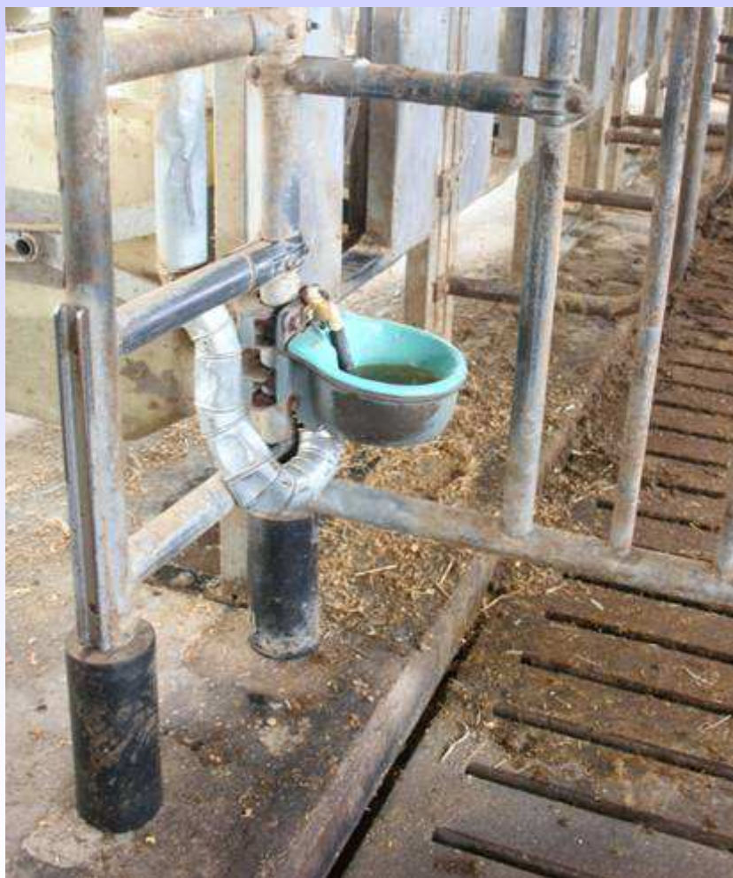
Beheizbares Tränkebecken mit Rohrbegleitheizung
